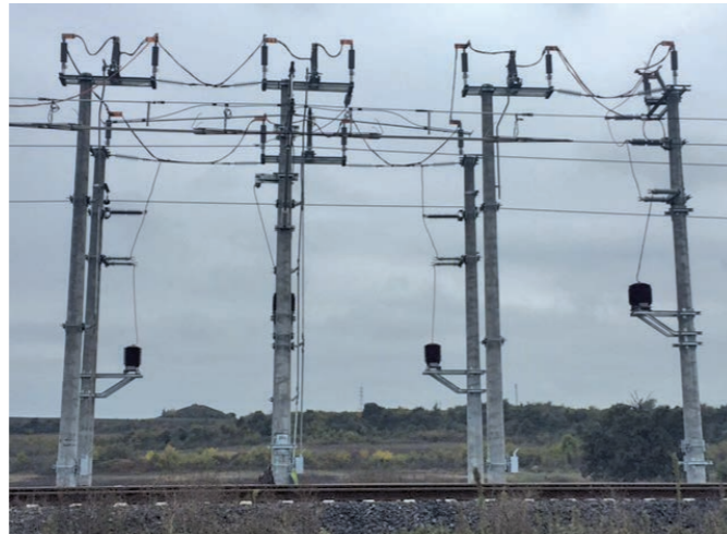
Секционна станция Нова Надежда
